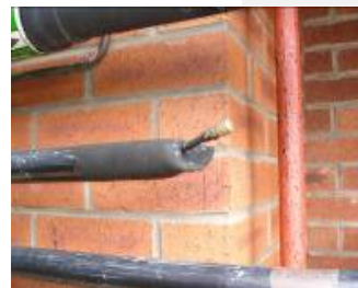
un Schrader mal monté en bout d'un tube cuivre mal étanché.
